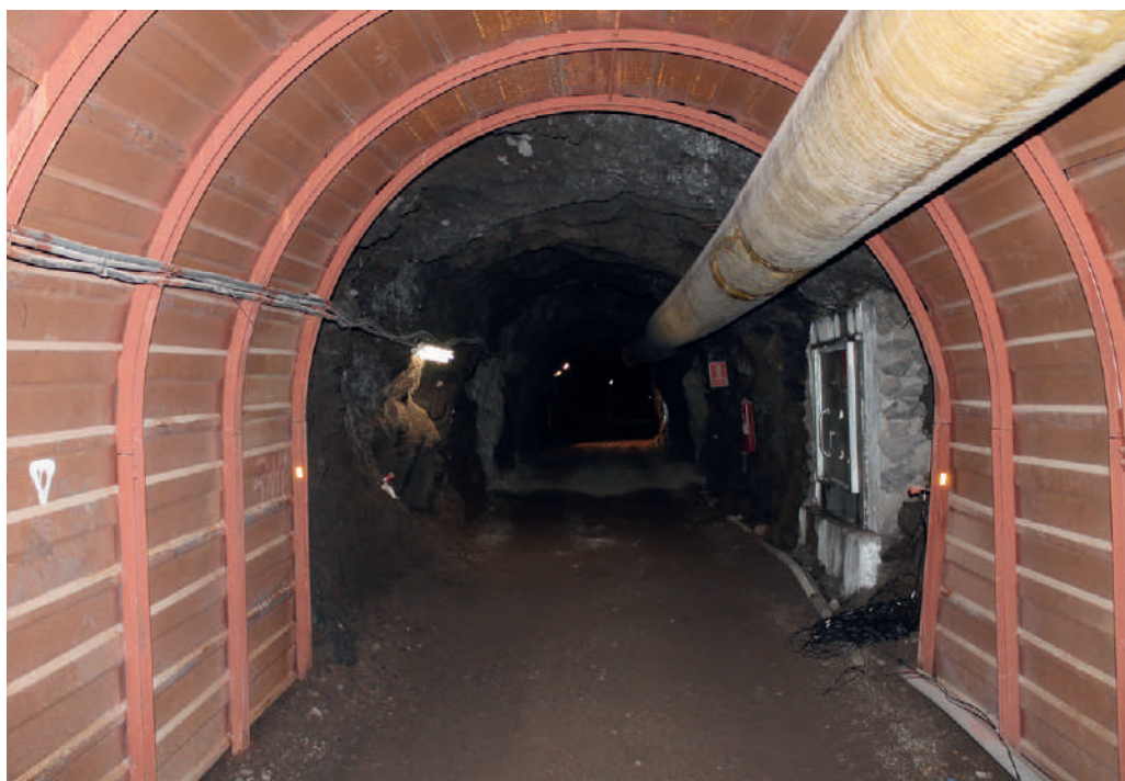
Figura 7.1.- Tubería flexible de ventilación.
