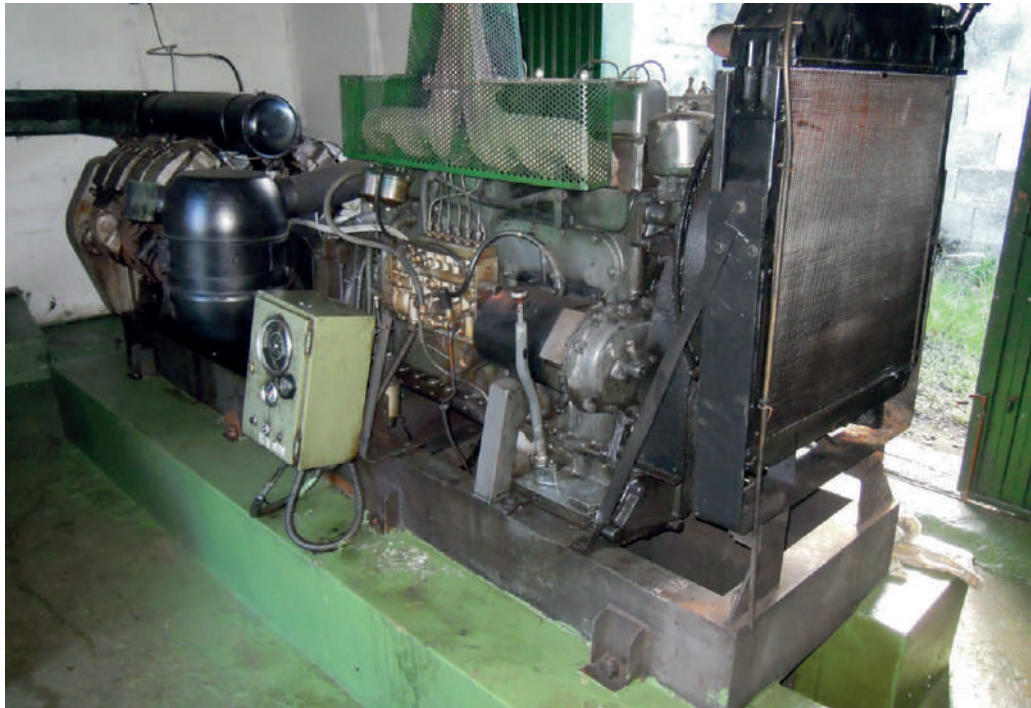
Figura 7.7.- Motor generador de energía para la instalación.
