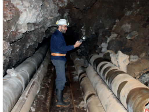
Figura 7.4.- Comprobación del funcionamiento de la ventilación.
