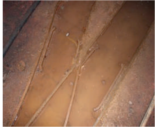
Figura A.11.- Railes en proceso de oxidación al estar "embebidos" en el agua de repisa de la mina.
