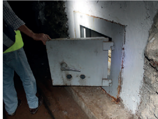
Figura 6.3.- Caja fuerte para el almacenaje de los explosivos.
