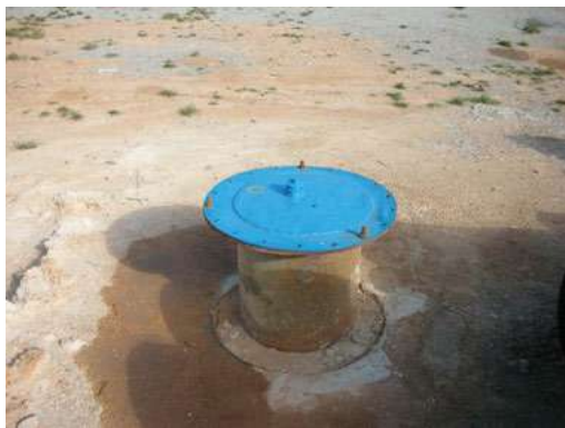
Cierre provisional hasta acondicionar.
