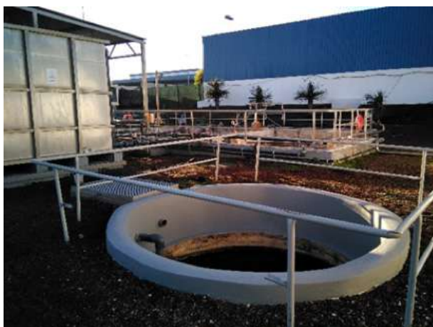
Figura 4.2. Instalaciones interiores de la depuradora de Guamasa
